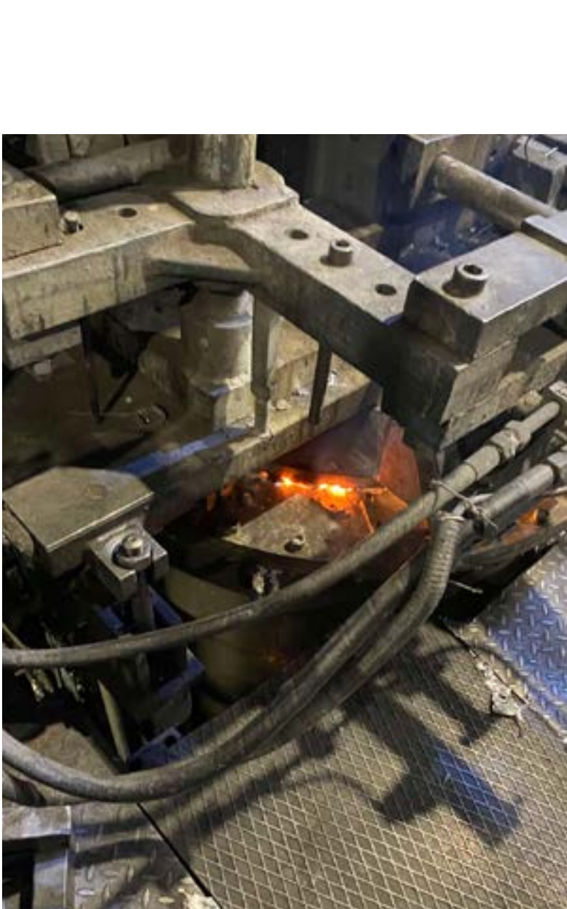
Slika 44. Detalj iz postrojenja za proizvodnju kamene vune/ Detail from stone wool production plant
