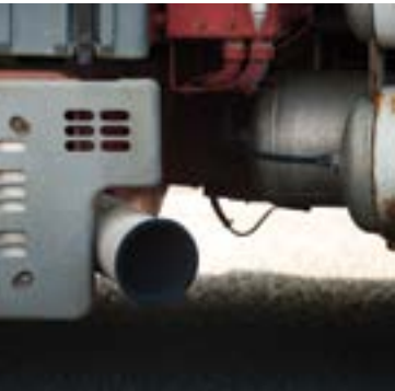
Izolacija ispušnih cijevi/ Insulation of exhaust pipes
