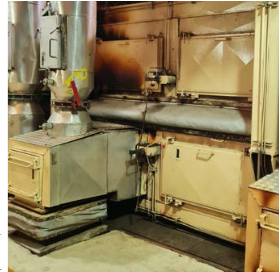
Slika 54. Detalj iz postrojenja za proizvodnju kamene vune/ Detail from stone wool production plant
