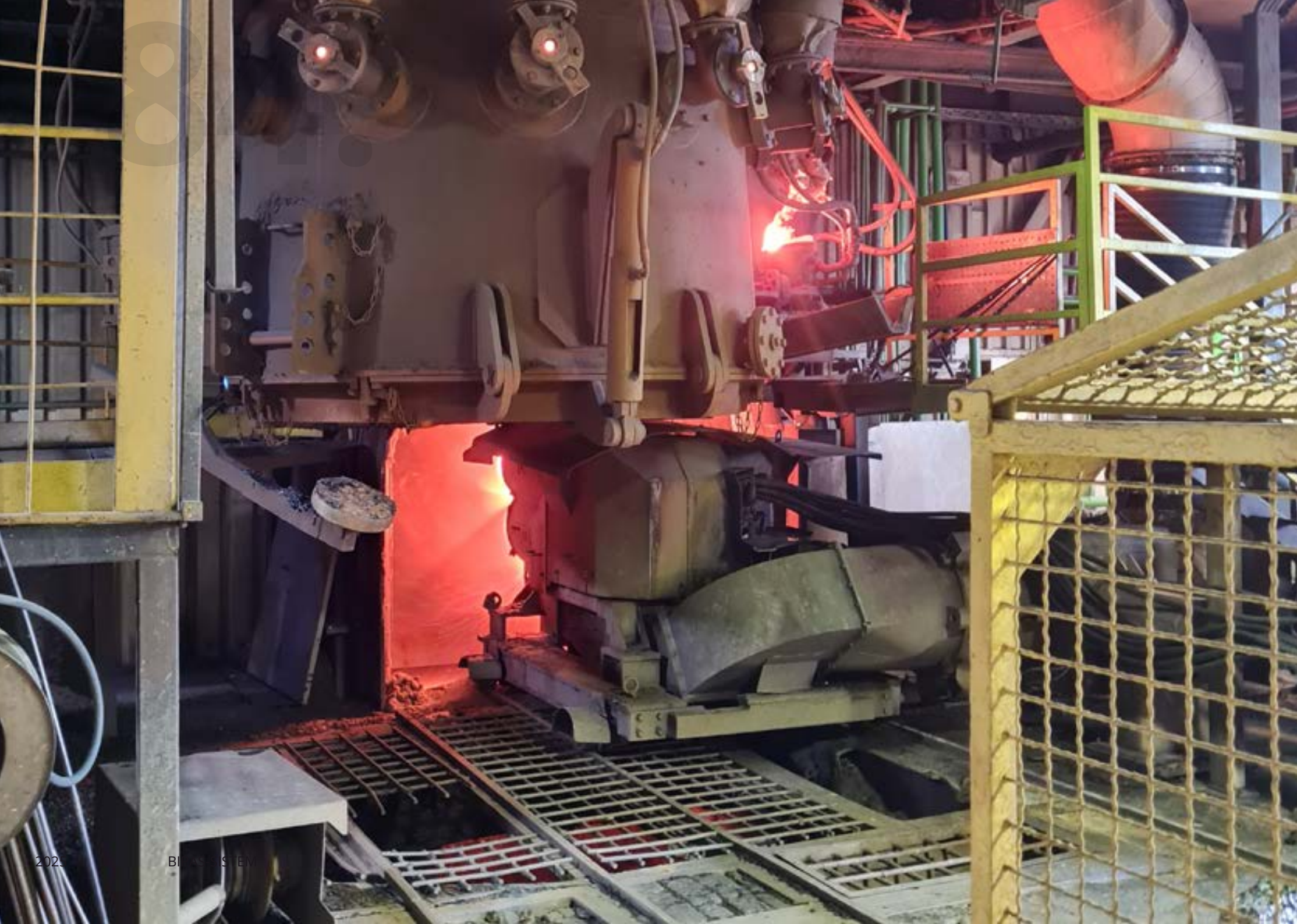
Slika 47. Detalj iz postrojenja za proizvodnju kamene vune/ Detail from stone wool production plant
