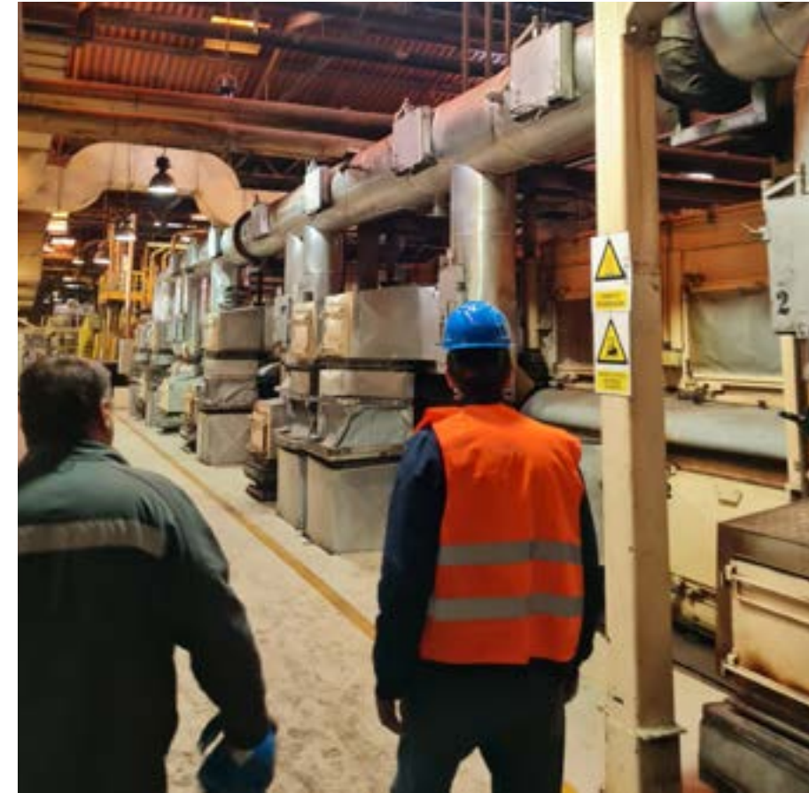
Slika 49. Detalj iz postrojenja za proizvodnju kamene vune/ Detail from stone wool production plant
