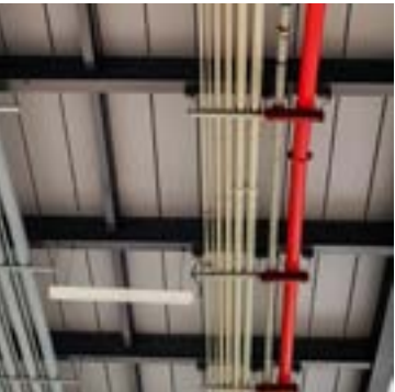
Zaštita električnih kablova/ Protection of electrical cables
